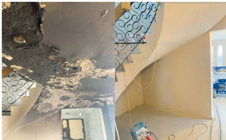
Eins og sjá má skemmdist hús Sirryar og Róberts mikið í brunanum en viðgerðir voru langt komnar og þau höfðu vonast til að geta flutt inn fyrir júl.
