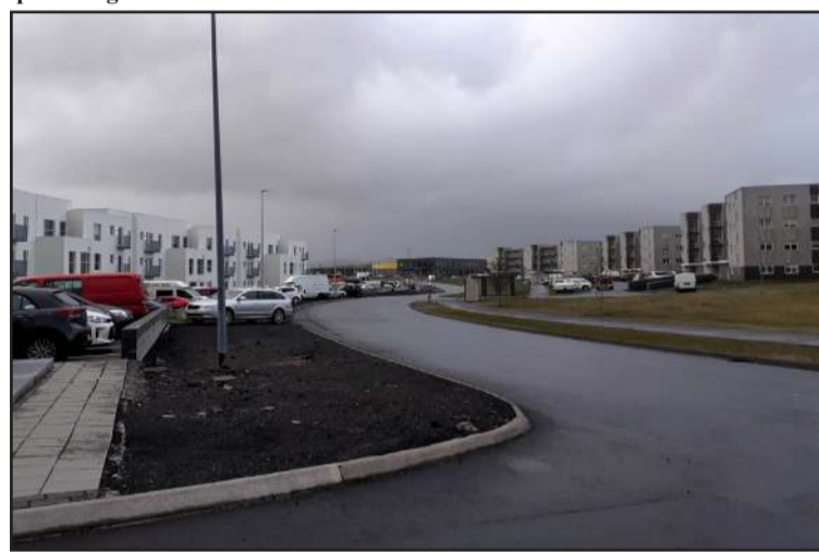
Elliðabraut. Unnið er að frágangi gangstétta við götuna og gönguþveranir verða þar gerðar á tveimur stöðum.
