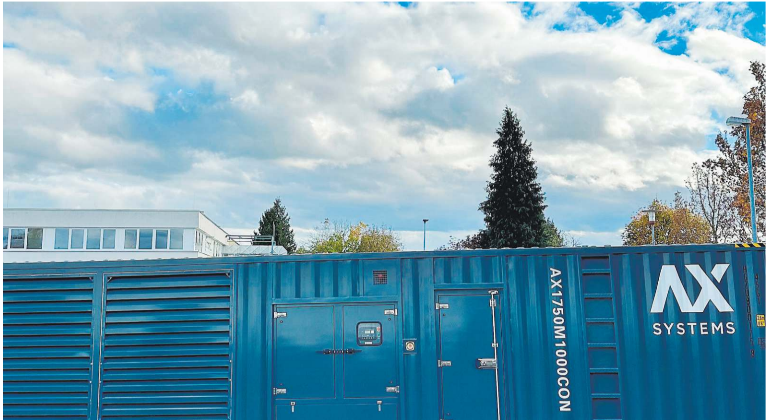
■ Hér má sjá 1750 kVA varaafstöð í 40 feta gámi sem sett var upp við gagnaver hér á landi.
