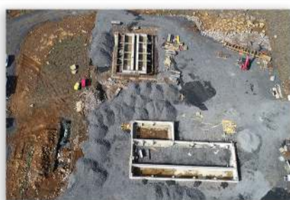
Landsnet hf. - Alverk Njarðvíkurheiði - Tengivirki og spennahús 323m 2 og 235m 2 - "Í vinnslu"
