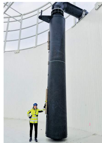
■ Súrefnisinnlosunarbúnaðurinn frá Linde í kerri First Water í Ölfusi er engin smásmíði. Hér stendur Alda Hlín við hlið hans en búnaðurinn er sá stærsti sem Linde hefur framleitt.
