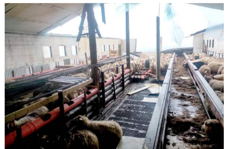
Mikið tjón varð á Vattarnesi sem er yst í sunnanverðum Fáskrúðsfirði. Þakið af fjárhúsunum fauk af og þak íbúðarhússins skemmdist. Mynd / Aðsend
