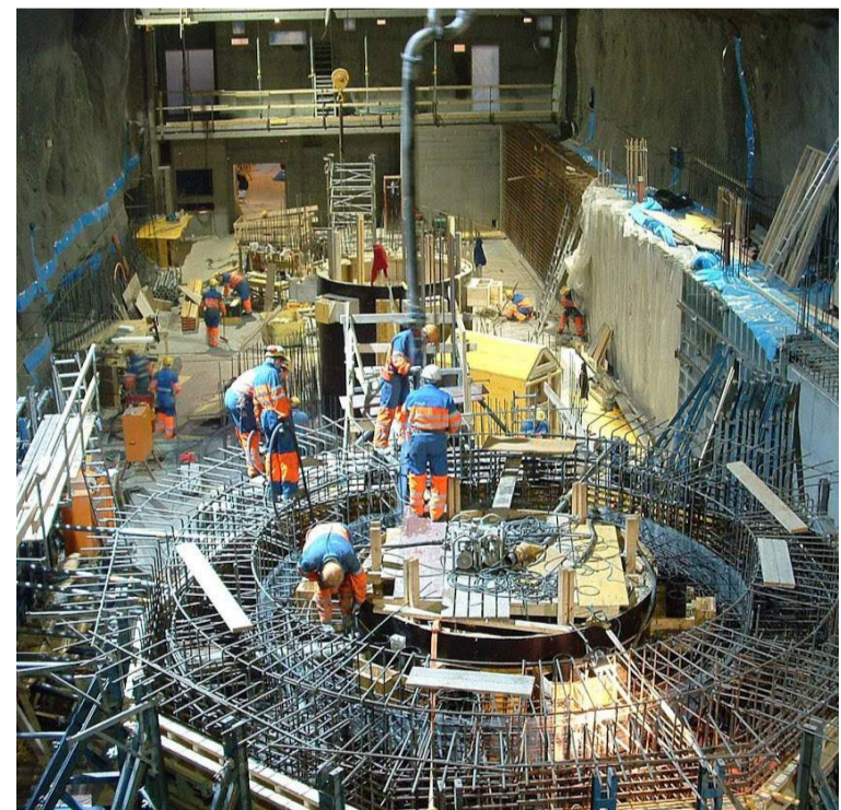
Fljótsdalsstöð kemur vel út í nýju sjálfbærnimati sem nú er opið til umsagnar. Myndin er úr Hverflasal stöðvarinnar í Valþjófsstaðarfjalli þegar stöðin var í byggingu. Fljótsdalsstöð var vígð síðla árs 2007. Mynd / sá
